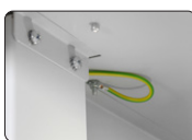
Mise à la terre de l'armoire
