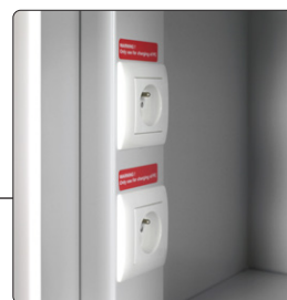
Chaque case est équipée de 2 prises électriques avec terre
